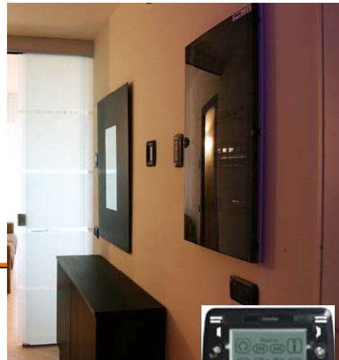
Esempio di appartamento cablato con MY-Home e con apparecchiature Living International
